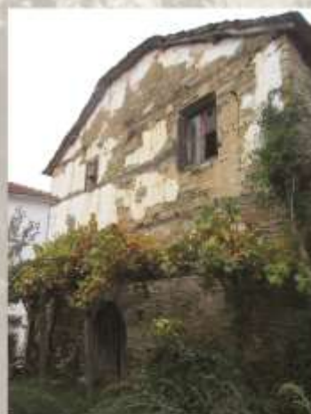
Οικία Αθανάσιου Αρμάγου. Διακρίνονται οι δοκοθήκες από το ξώστεγο, η αρχική πόρτα εισόδου με το καμπύλο ανώφλι και το ίκνος από την πόρτα που οδηγούσε στο ξώστεγο και αντικαταστάθηκε με παράθυρο.
